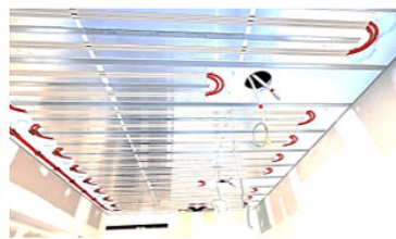
(b) Superficie térmica con tubería
